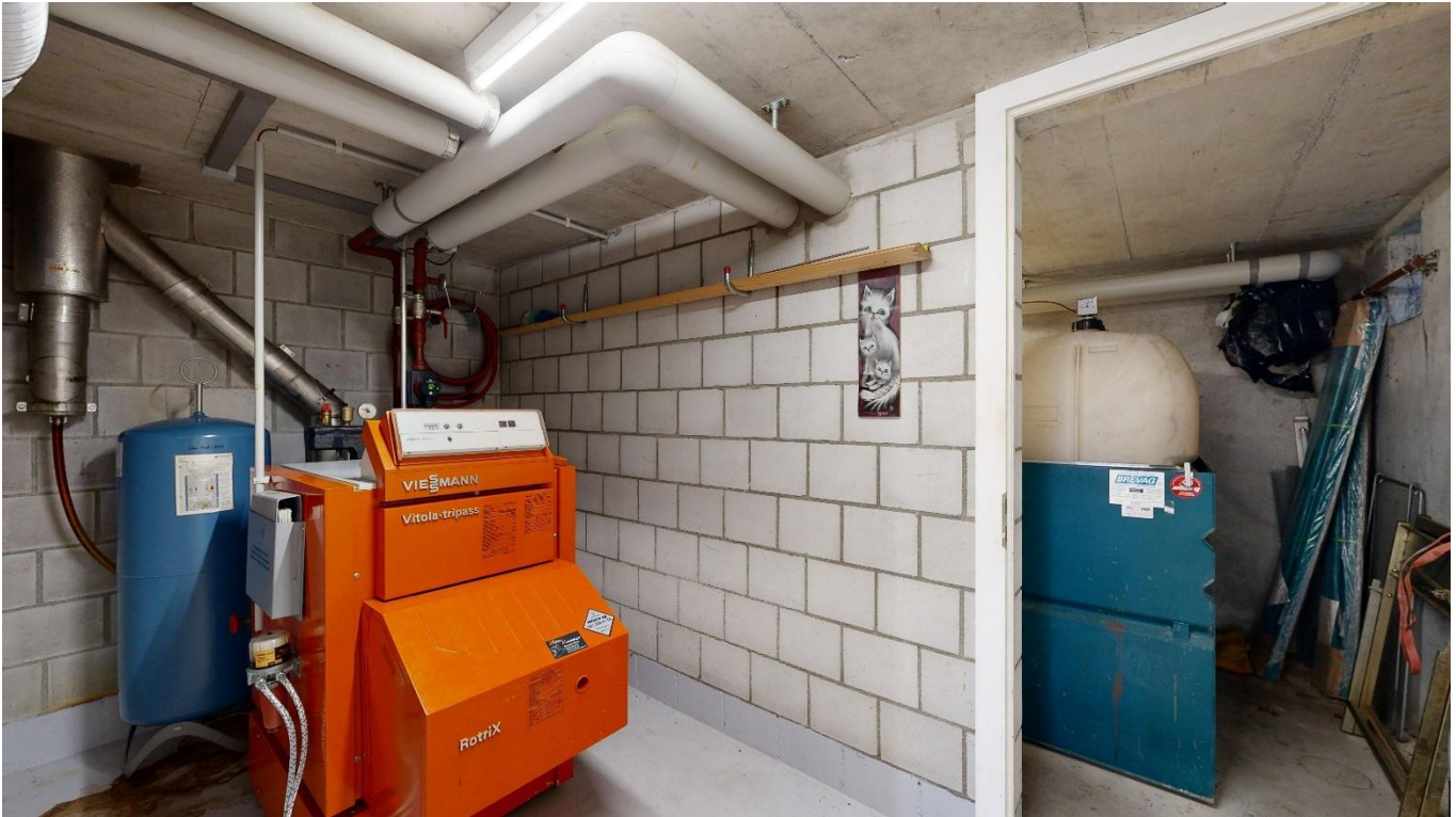
Heizungsraum und Tankraum (UG)
