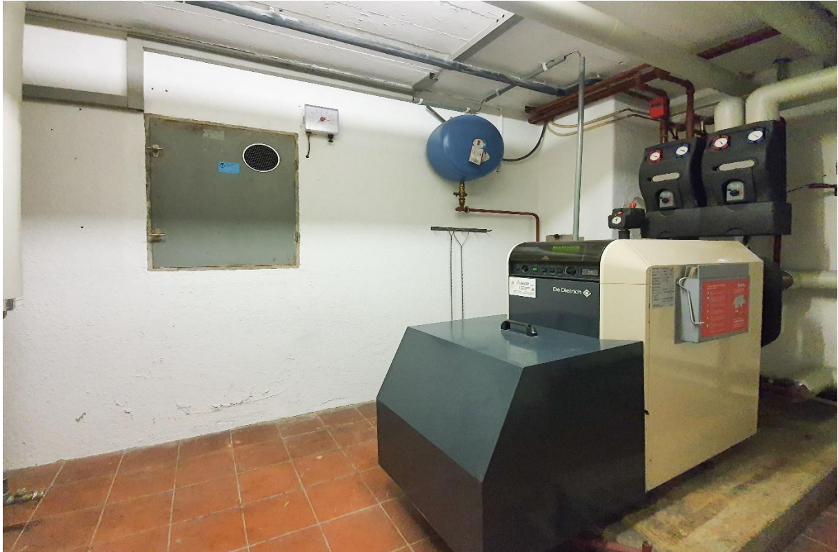
Der Technikraum mit Heizung, Boiler und Öltank
