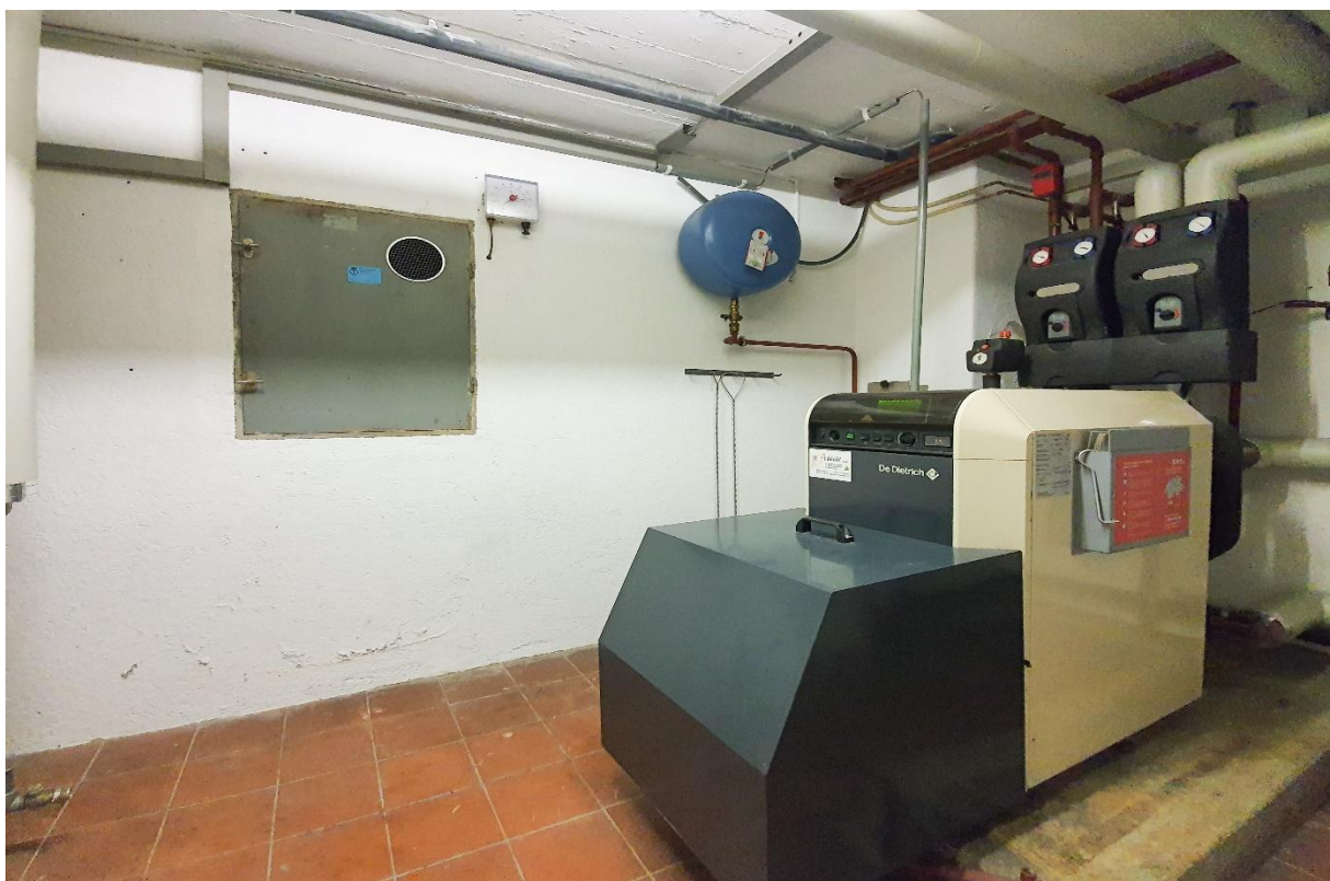
Der Technikraum mit Heizung, Boiler und Öltank
