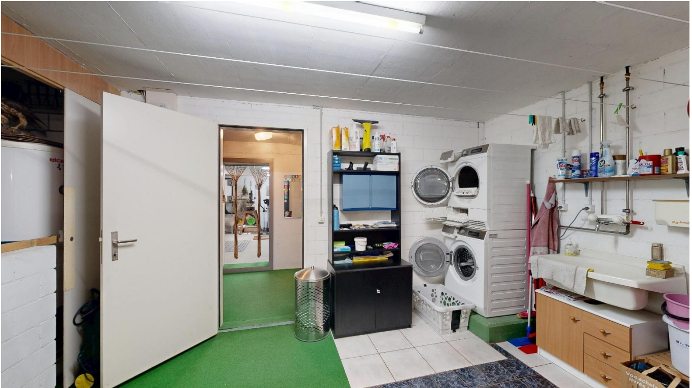
Waschküche/Technik-/Heizungsraum mit Waschmaschine, Tumbler und Lavabo (UG)
